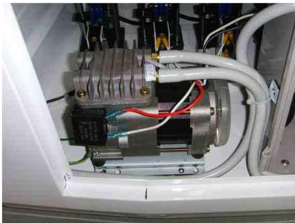
Рис. ГМотор системы водоснабжения
